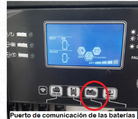
Puerto de comunicación de las baterías
